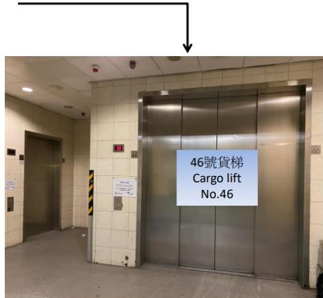
貨梯大堂入口 Cargo Lift lobby entrance
