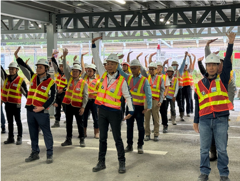
土木工程拓展署署長方學誠先生到工地向前線人員及工友推廣安全文化，以加強保障工友的安全
