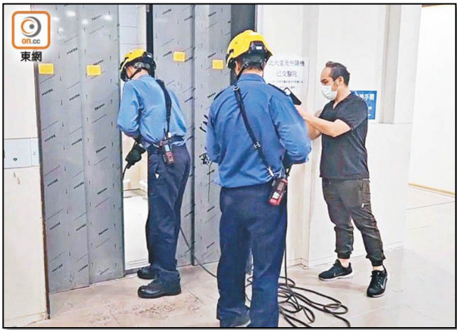
南區工地一工人 遭升降機機廂 夾斃
