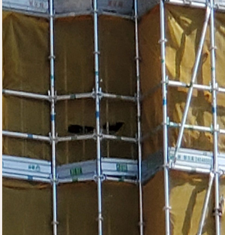
破損 / 鬆動的安全網 可能會導致人員 / 物體掉落
