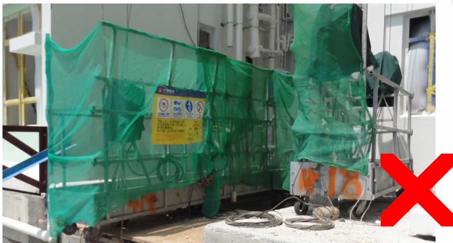
施工方案沒有說明吊船的額外設施
