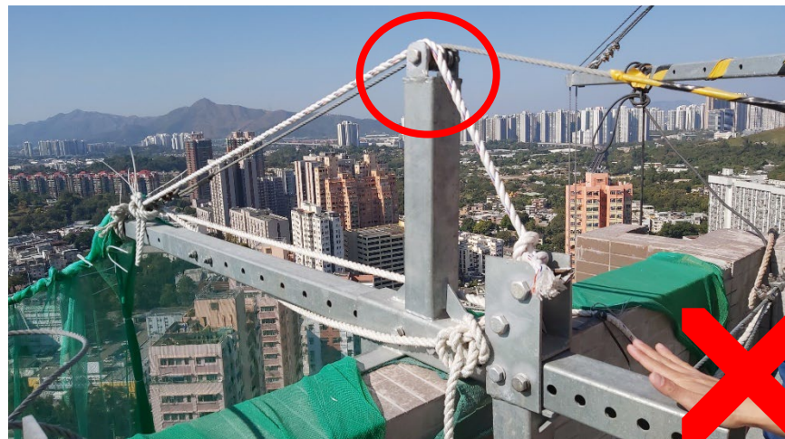
獨立救生繩不正確連接 吊船支撐架
