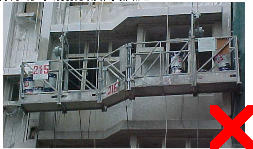
吊船在無人操作下 沒有將吊船停於指定進出口樓層且存放過量物料
