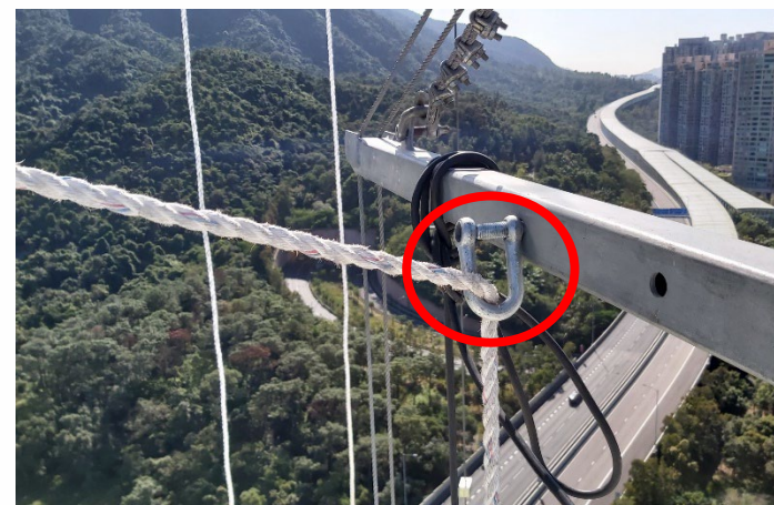
獨立救生繩不正確連接吊船支撐架
