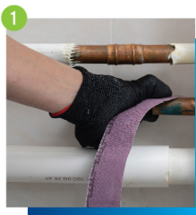
1 清潔供水管接駁口，並確保沒有異物阻塞在管道內
