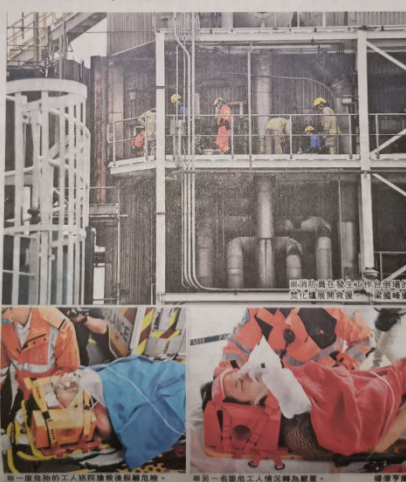
■一處倒塌的工人因被磚塊壓傷而受傷。 一名工人因被磚塊壓傷而受傷。 一名工人因被磚塊壓傷而受傷。
