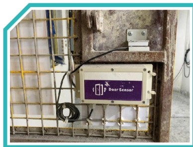
在閘門內側安裝窄頻物聯網（NB-IoT）感應器
