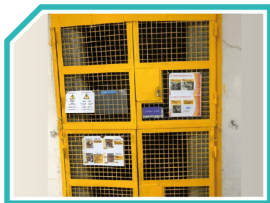
在升降機槽前安裝四葉門是關鍵的安全措施
