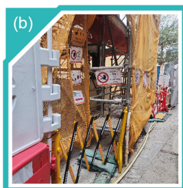
伸縮圍欄 (交通管理)
